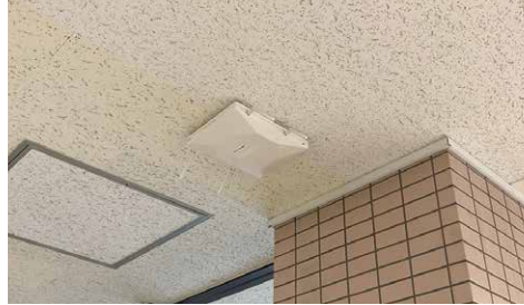
▲手稲あんじゅに設置された無線LANアクセスポイント
